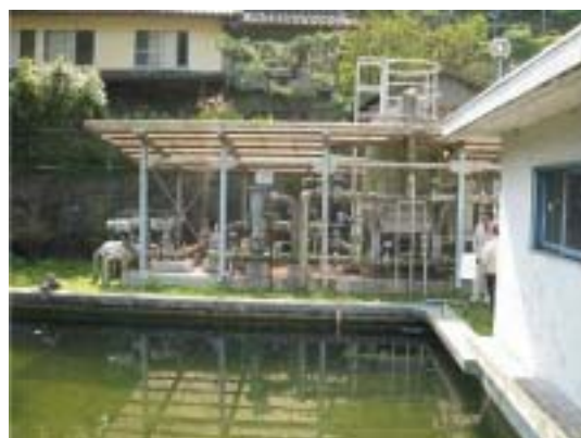
川之内浄水場の前処理設備
