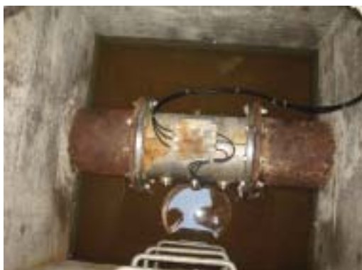
- 愛宕第2配水池の配水管ピット内 -
