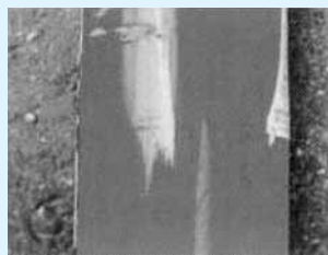
使用に耐えない変形
