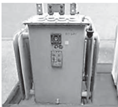
高圧トランスの例
