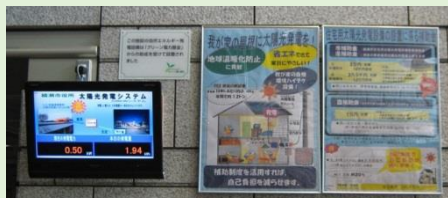
写真3 発電状況表示モニター
