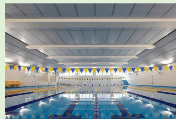
写真1 学校プールにおける地中熱利用
