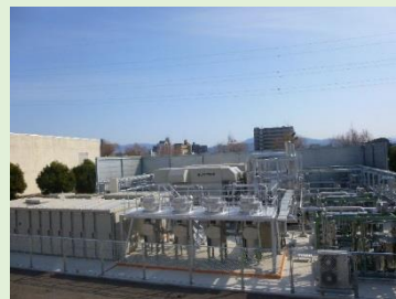
写真2 中央浄化センターにおける消化ガス発電
