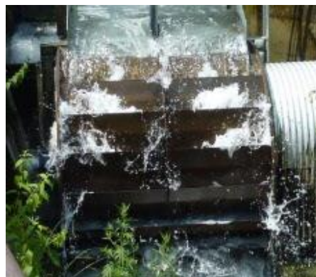
図 1-6 家中川小水力市民発電所
