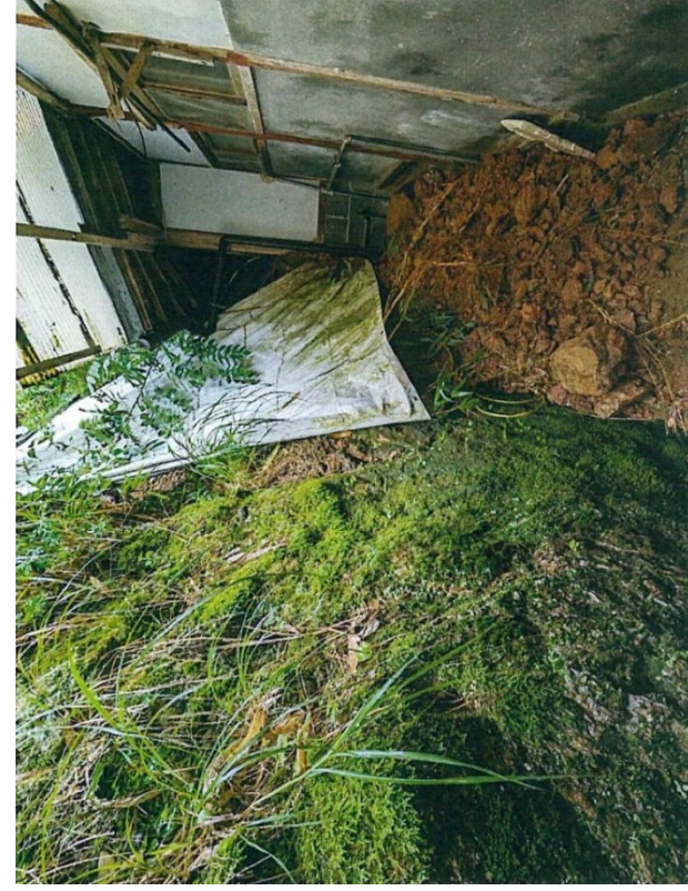
㉓がけ崩れ(谷地区)
