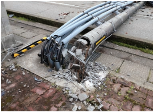
▲根元から折れた電柱。地震の威力を物語っています。(輪島市)
