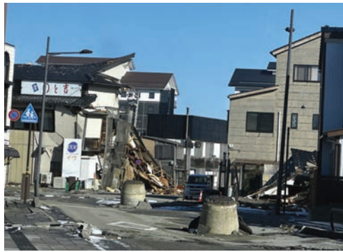
▲地震によって浮き上がったマンホールや倒壊した建物(輪島市)
