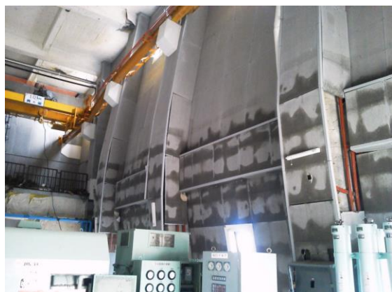
津波波圧による壁面の変形（内部）
