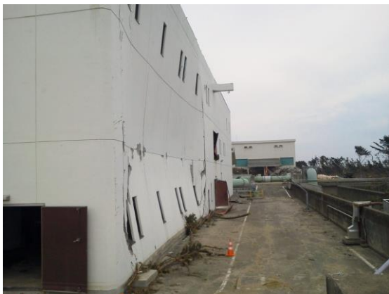
津波波圧による壁面の変形（外観）
