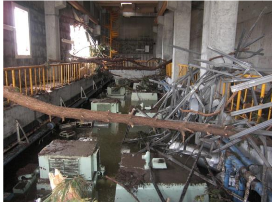
漂着物による施設内部の破損
