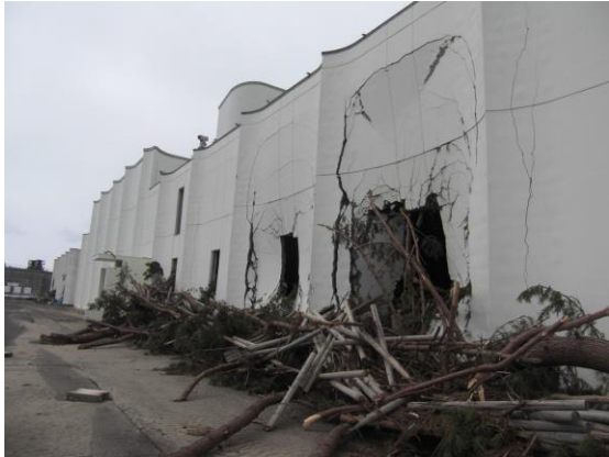
津波波圧による壁面の破損
