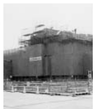
浄化センター（保内処理区）
